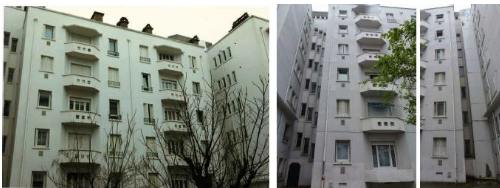
Façade en 1995 (gauche) et en 2015 (droite et bas)
